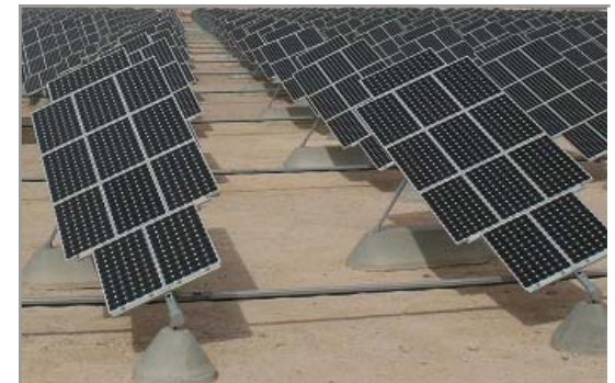
210-MW c-Si Tracking PV
